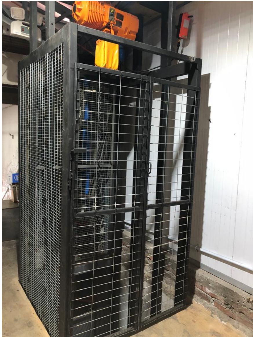
Ilustración 13: Elevador de segundo piso de Distribuidora New York
